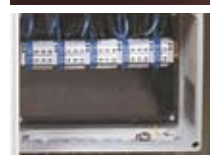
Espacio para conexiones
