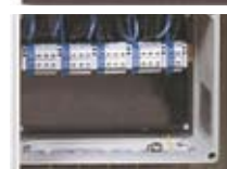
Espacio para conexiones
